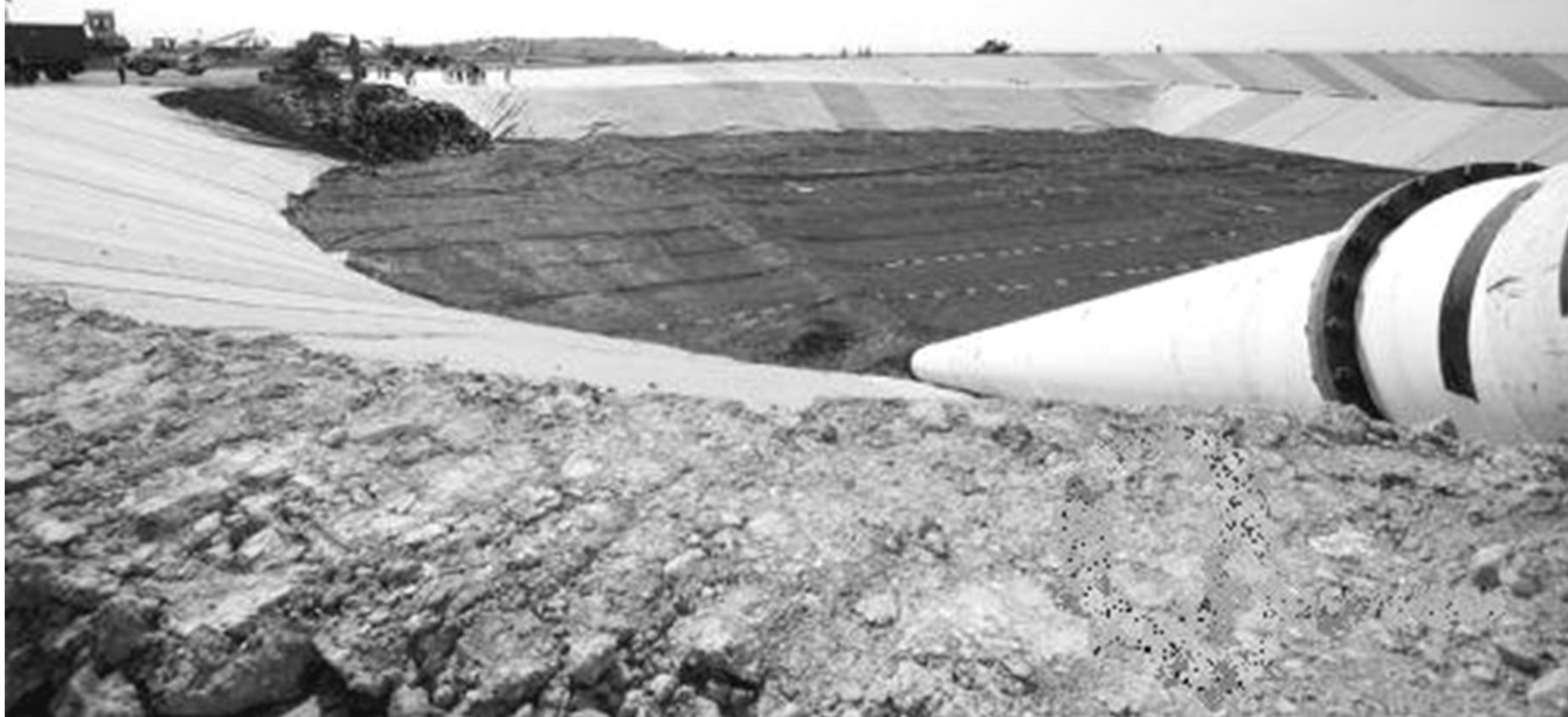
C.da Nocecchia, dopo l'inizio dei lavori, la militarizzazione, lo sversamento...
